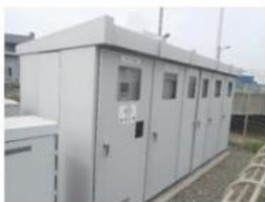
【図1】キュービクル（高圧受電設備）
